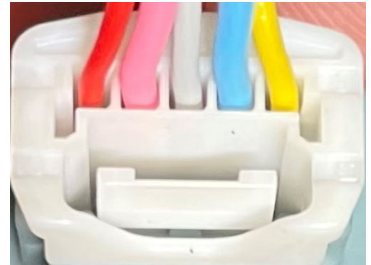
Gelbes Kabel am Bremslichtschalter - Pin 5 (Zündung)
