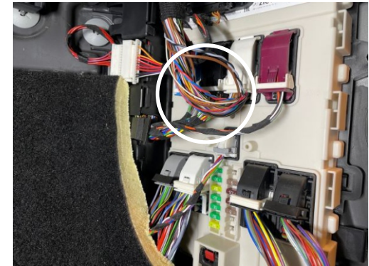
CAN Bus Verbindung am BCM in der rechten A-Säule.
